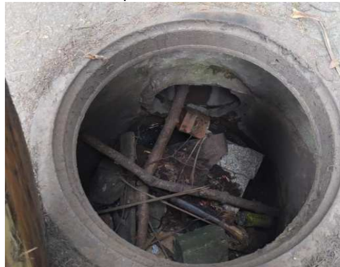
Imagen 55. Evidencia 1 de estado actual del sistema de alcantarillado pluvial en la zona 2
