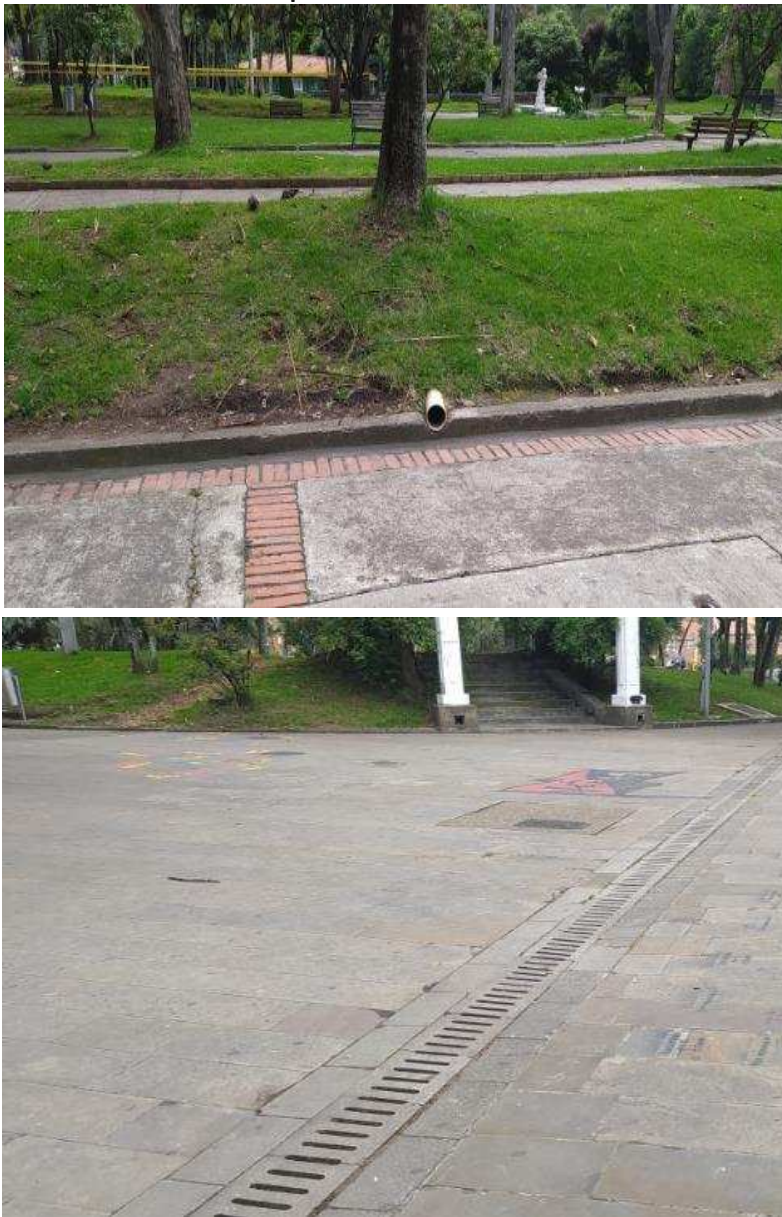
Imagen 56. Evidencia 2 de estado actual del sistema de alcantarillado pluvial en la zona 2
