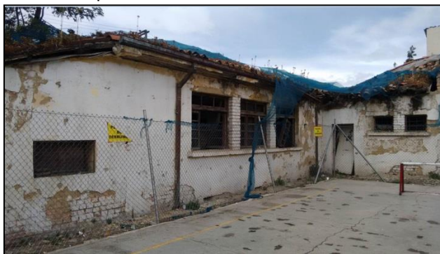
Inmueble Calle 65 sur No. 80I-40. Colegio Francisco de Paula Santander. Uno de los volúmenes del Colegio presenta Amenaza de Ruina por lo que se informó al responsable del inmueble sobre su obligación de intervenir el inmueble para procurar su conservación.
