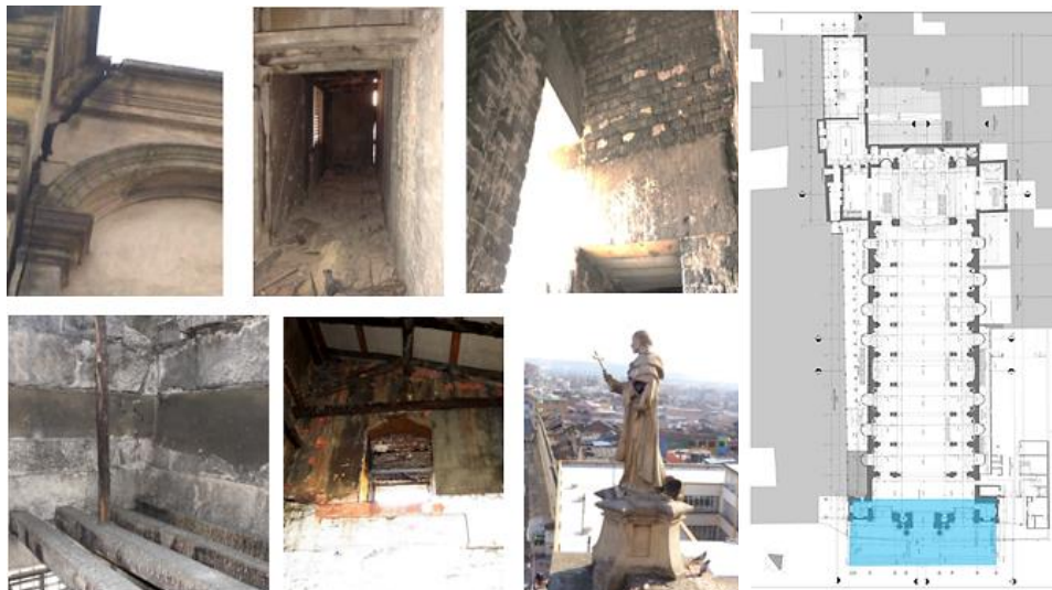
Figura 23. Estado actual de la fachada y contrafachada de la Basílica
