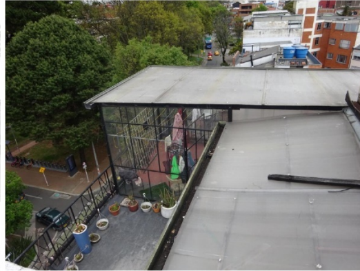
Ampliación en el 6 piso sin licencia de construcción. Vista desde la terraza
