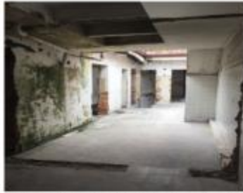
Vista inferior predio 2 segunda piso, parte de la unidad original conformada por los predios 1 y 2.
