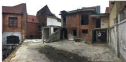
Estado actual fachada interior vista desde los patios. Fuente: estudio de valoración aportado por el solicitante, 2022.
