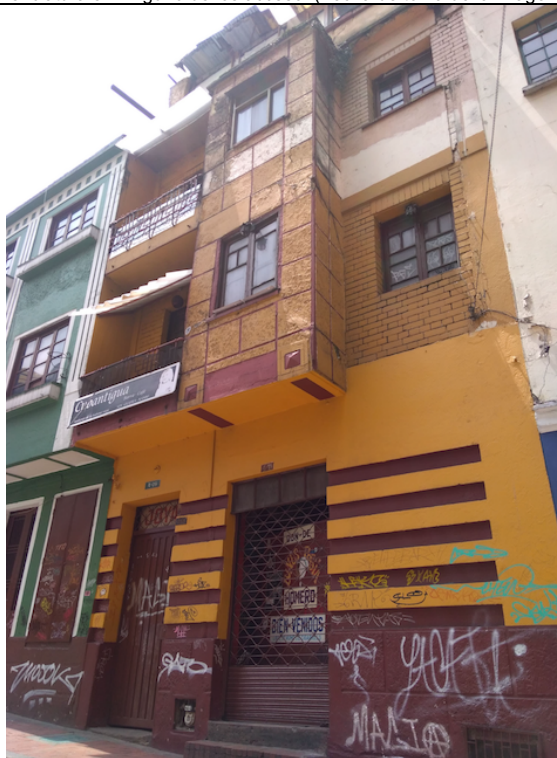
Fotografía 2 –Fachada del predio ubicado en la Calle 12D No. 4-09 y/o Carrera 4 No. 12 C-93, sobre la Calle 12 D. Se evidencia el avanzado estado de deterioro de la fachada, y el nivel adicional construido que no corresponde a la tipología ni características del resto del inmueble. Se exhibe un aviso del local comercial "Cuba antigua" (Fecha de toma de la imagen 18 de marzo de 2020).
