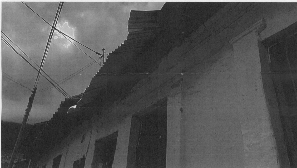
Se evidencia intervención reciente de una sección de cubierta de la construcción que anteriormente era en teja de barro. Fotografía 3 – (Fecha de toma de la imagen 30 de julio del 2019).
