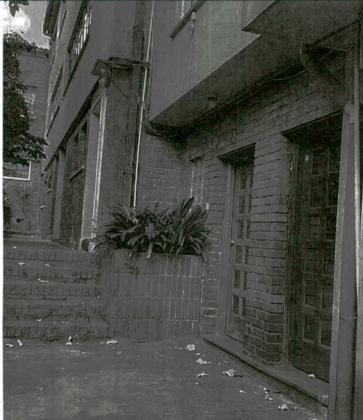
Fotografía 5 – Fotografía tomada a través de la reja de acceso principal del inmueble, en la que no se evidencia pormenores de la denuncia. (Fecha de toma de la imagen 12 de agosto de 2020).
