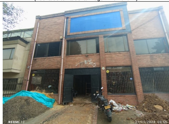
Fotografía 4 – fachada principal inmueble de la AK 28 36 32 sobre la avenida carrera 28. (Fecha de toma de la imagen 21/11/2024 ).
