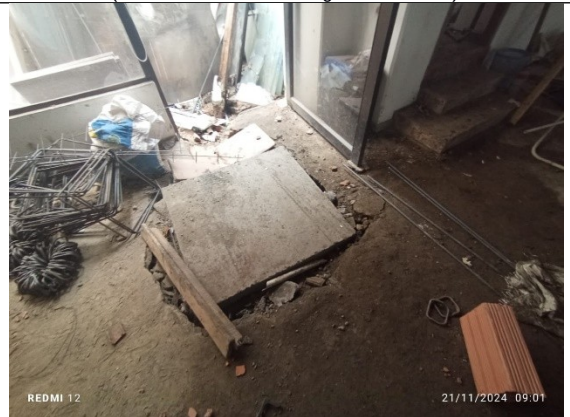
Fotografía 16 – intervenciones en las cajas de inspección. Véase el estado actual de la placa de contrapiso. (Fecha de toma de la imagen 21/11/2024 ).
