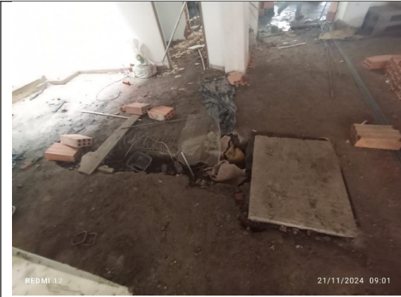
Fotografía 13 – intervenciones en las cajas de inspección. Véase el estado actual de la placa de contrapiso. (Fecha de toma de la imagen 21/11/2024 ).
