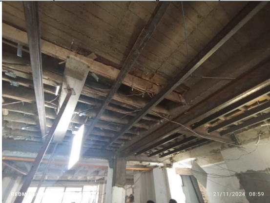
Fotografía 9 – estado actual de la placa de segundo piso en la cual se evidencia la instalación de perfiles estructurales con el fin de cualificar la estructura existente.
