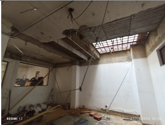
Fotografía 7 – estado actual de uno de los espacios del primer piso en el cual se evidencian deterioros generales en la placa de segundo piso.
