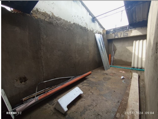
Fotografía 25 – espacio en el cual se puede evidenciar el estado actual de una fracción de la cubierta y deterioros presentes. (Fecha de toma de la imagen 21/11/2024).
