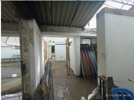
Fotografía 29 – espacio del tercer piso en el cual se evidencia una cubierta en eternit con estructura en cercha metálica. Se pueden ver escombros y elementos metálicos en el piso, además de tejas deterioradas. (Fecha de toma de la imagen 21/11/2024).
