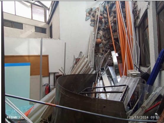
Fotografía 15 – espacio de uno de los aislamientos posteriores del inmueble con acopio de materiales y escombros. (Fecha de toma de la imagen 21/11/2024 ).
