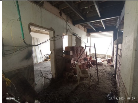
Fotografía 10 – estado actual de la placa de segundo piso en la cual se evidencia la instalación de perfiles estructurales con el fin de cualificar la estructura existente y acopio de materiales.
