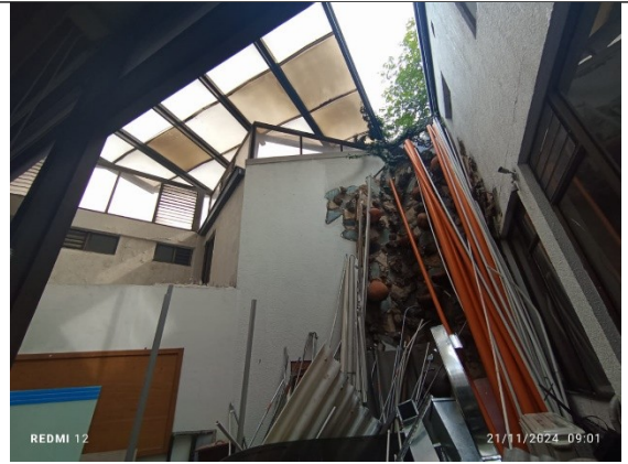
Fotografía 14 – espacio de uno de los aislamientos posteriores del inmueble con acopio de materiales y escombros. (Fecha de toma de la imagen 21/11/2024 ).
