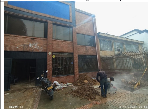
Fotografía 5 – ejecución de intervenciones en el área del antejardín que se pueden relacionar con las cajas de inspección. (Fecha de toma de la imagen 21/11/2024 ).
