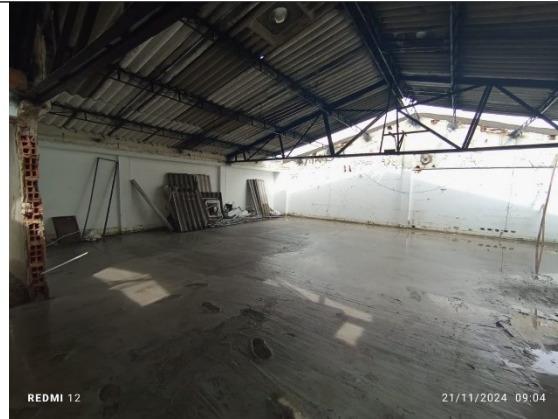
Fotografía 26 – espacio del tercer piso en el cual se evidencia una cubierta en eternit con estructura en cercha metálica. (Fecha de toma de la imagen 21/11/2024).
