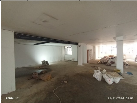
Fotografía 17 – espacio del segundo piso en el cual se puede ver unos elementos metálicos en la placa de entrepiso, y presencia de materiales y escombros. (Fecha de toma de la imagen 21/11/2024 ).
