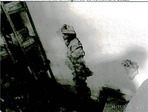
Fotografía 13 – Regatas y troneras existentes al momento de la visita realizada. (Fecha de toma de la imagen 30 de noviembre 2022).
