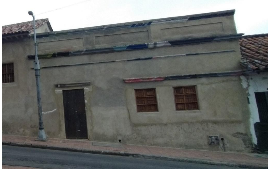
Fotografía 6: Vista de la fachada principal del inmueble de la CL 9 1 15 , en donde se observan solo 2 de las 3 ventanas aprobadas en la planimetría de la Resolución IDPC No 668.
