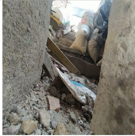
Fotografía 6 – Presencia de escombros en el inmueble de CL 12C 1 09 vistos y registrados desde el exterior. (Fecha de toma de la imagen 21/06/2023 ).
