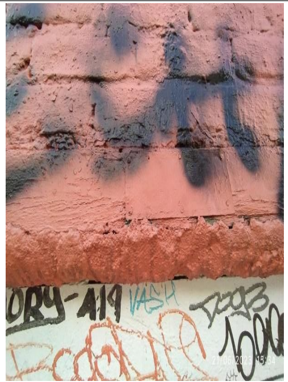
Fotografía 8 – Nomenclatura ilegible del inmueble de la CL 12C 1 09 sobre la carrera 1. (Fecha de toma de la imagen 21/06/2023 ).
