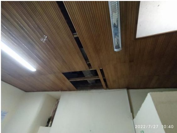
Fotografía 7 – Deterioro de cielorraso existente en madera machihembrado en espacio de servicio. Inmueble No. 3: KR 4 9 37 (Fecha de toma de la imagen 27 de julio de 2022).
