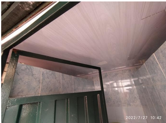
Fotografía 13 – Instalación de cielorraso en PVC blanco en baños exteriores. Inmueble No. 5: CL 9 4 40. (Fecha de toma de la imagen 27 de julio de 2022).
