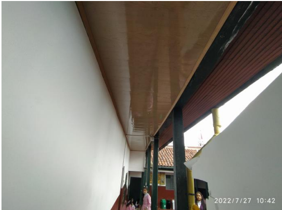
Fotografía 11 – Instalación de cielorraso en PVC imitación madera en pasillo exterior lateral. Inmueble No. 5: CL 9 4 40. (Fecha de toma de la imagen 27 de julio de 2022).
