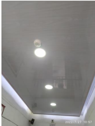
Fotografía 5 – Instalación de cielorraso en PVC blanco en el ingreso. Inmueble No. 3: KR 4 9 37 (Fecha de toma de la imagen 27 de julio de 2022).
