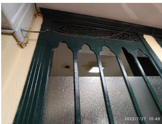
Fotografía 22 – Presencia de deterioros por desprendimiento en cielorrasos existentes. Inmueble No. 1: CL 9 4 10. (Fecha de toma de la imagen 27 de julio de 2022).
