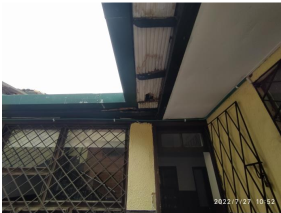
Fotografía 25 – Presencia de deterioros asociados a humedades por filtraciones. Inmueble No. 1: CL 9 4 10. (Fecha de toma de la imagen 27 de julio de 2022).
