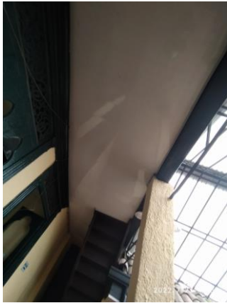
Fotografía 23 – Instalación de cielorraso en PVC blanco en espacios de circulación internos. Inmueble No. 1: CL 9 4 10. (Fecha de toma de la imagen 27 de julio de 2022).
