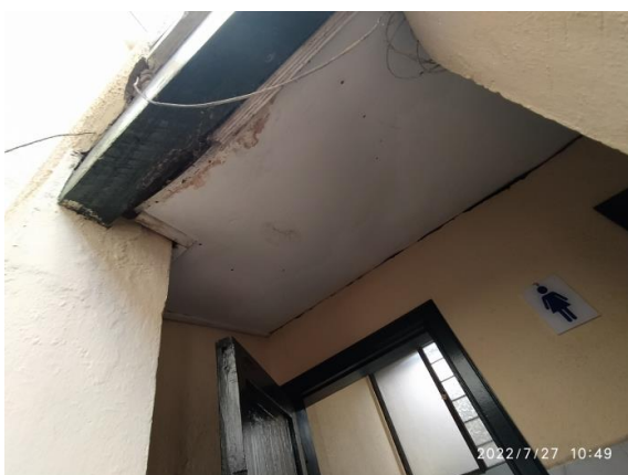
Fotografía 21 – Presencia de deterioros asociados a humedades por filtraciones. Inmueble No. 4: CL 9 4 24. (Fecha de toma de la imagen 27 de julio de 2022).
