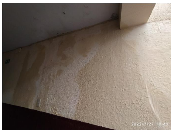
Fotografía 20 – Presencia de deterioros asociados a humedades en muros. Inmueble No. 4: CL 9 4 24. (Fecha de toma de la imagen 27 de julio de 2022).
