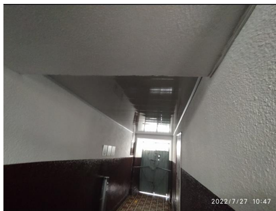
Fotografía 18 – Instalación de cielorraso en PVC blanco espacios de circulación internos. Inmueble No. 4: CL 9 4 24. (Fecha de toma de la imagen 27 de julio de 2022).
