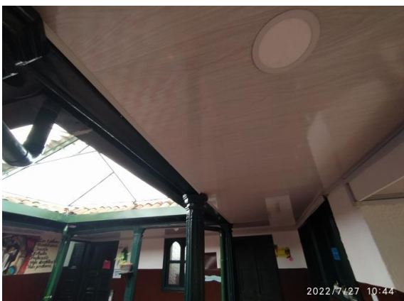
Fotografía 15 – Instalación de cielorraso en PVC blanco entorno a pasillos de patio central. Inmueble No. 5: CL 9 4 40. (Fecha de toma de la imagen 27 de julio de 2022).
