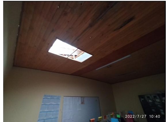
Fotografía 8 – Deterioro de cielorraso existente en madera machihembrado en un salón. Inmueble No. 3: KR 4 9 37 (Fecha de toma de la imagen 27 de julio de 2022).
