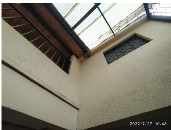
Fotografía 19 – Presencia de deterioros asociados a humedades por filtraciones. Inmueble No. 4: CL 9 4 24. (Fecha de toma de la imagen 27 de julio de 2022).
