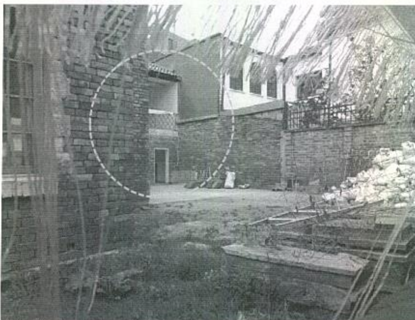
Fotografía 3 – A través de la poli sombra ubicada en el perímetro del inmueble, se alcanza a observar la aparente construcción de un segundo nivel sobre volumen posterior, el cual fue construido sin ningún tipo de autorización para tal fin. (Fecha de toma de la imagen 23/08/2022).
