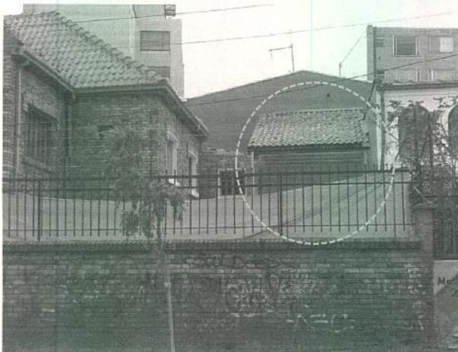
Fotografía 2 – Por la calle 46, se evidencia la instalación de poli sombra color verde, que cubre la visibilidad hacia el interior del inmueble. En la parte posterior, se observa una ampliación realizada sin licencia y sin las debidas autorizaciones que superan las reparaciones locativas autorizadas por el IDPC. (Fecha de toma de la imagen 23/08/2022).
