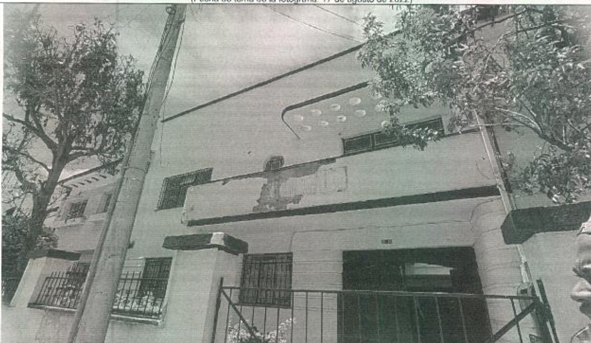
Fotografía 3 – Se observa deterioro en fachada en especial zona en donde antes existía un aviso en el balcón predio ubicado en la Carrera 16 A No. 30 – 78. (Fecha de toma de la fotografía: 17 de agosto de 2022)
