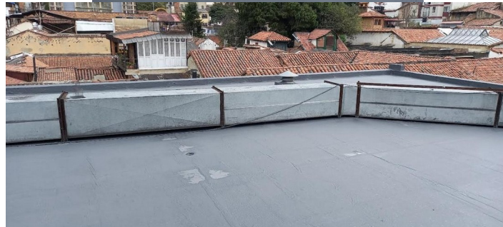
Fotografía 5 y 6: Se observa el extractor encima de la cubierta del inmueble Calle 11 No. 3-11.
