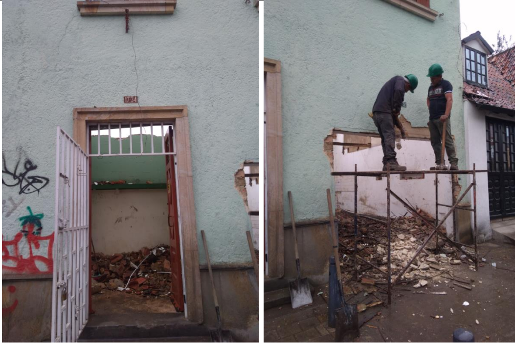
Fotografías 3 y 4 – Desde el exterior del inmueble, se alcanza a observar que al interior del inmueble también se habían llevado a cabo demoliciones parciales de muros y desmonte de entrepiso. Había una importante cantidad de escombros de demolición ubicados al interior del predio. (Fecha de toma de la imagen 05 de mayo de 2022).
