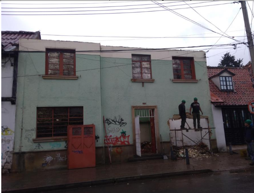
Fotografía 2 –Fachada principal del inmueble, se evidencia la remoción total de la cubierta, y la ejecución de la demolición del vano de garaje del inmueble. (Fecha de toma de la imagen 05 de mayo de 2022).
