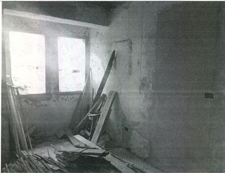
Fotografía 25 – En los espacios interiores del tercer nivel de la parte frontal del edificio se evidencia retiro de acabados de cielorraso, pisos en madera. Resane y alisado de vanos, y tapiado de vanos de comunicación interior entre espacios. (Fecha de toma de la imagen 18/07/2022).
