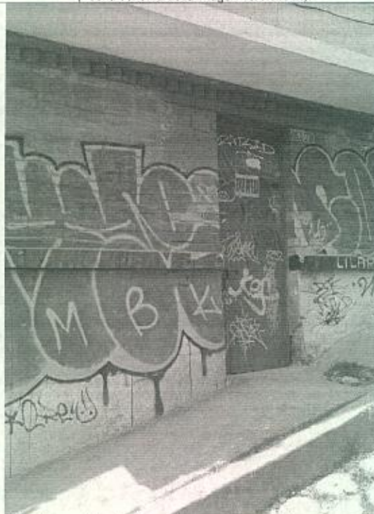
Fotografía 2 – En el primer nivel sobre la fachada, se evidencian dos ventanas y una puerta de acceso originales tapiadas con ladrillos y todo el primer nivel con grafitis. (Fecha de toma de la imagen 18/07/2022).
