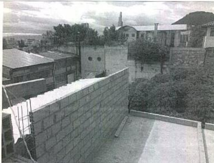
Fotografía 37 – Desde el cuarto nivel construido en la parte frontal del predio, se logra evidenciar que en la parte posterior, y por encima de la placa del segundo nivel, se han iniciado hiladas de mampostería para agregar lo que podría ser un tercer nivel en la parte posterior del predio. Superando en altura a su colindante lateral.
