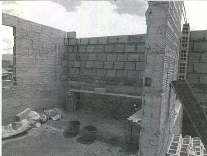
Fotografía 33 – En la parte frontal del predio, se evidencia la construcción de un nivel adicional a la altura original del inmueble, con muros en mampostería y placa fácil en el entre piso. (Fecha de toma de la imagen 18/07/2022).
