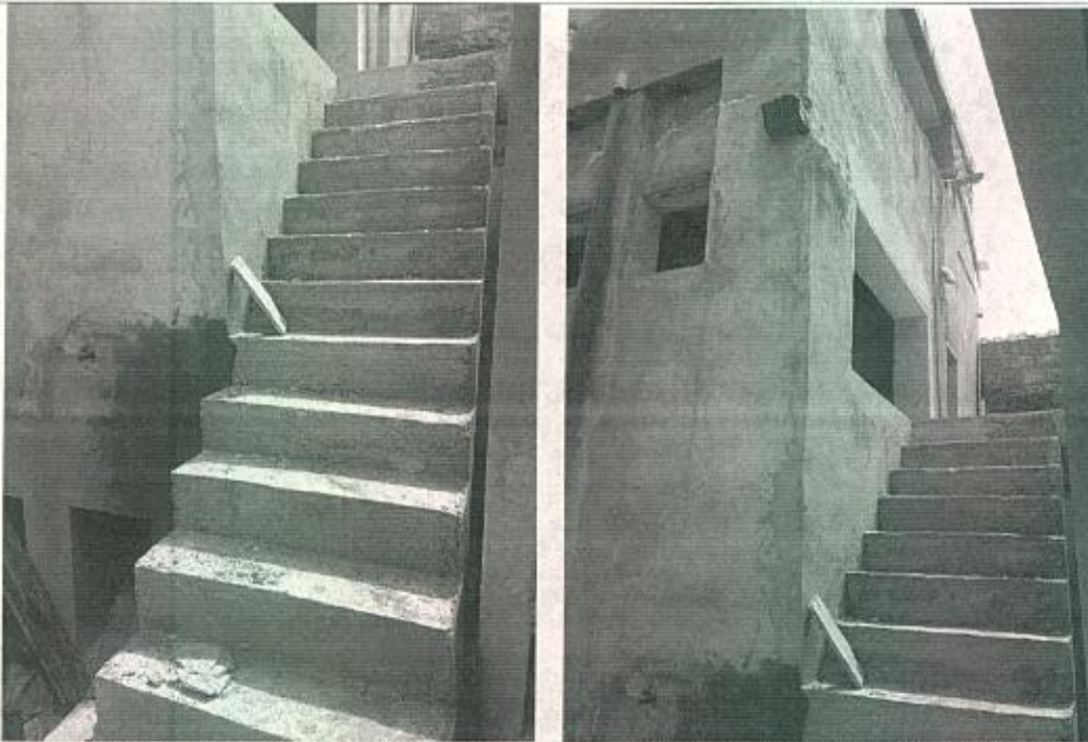
Fotografía 21 y 22 – El pasillo de acceso a las habitaciones del segundo nivel de la parte posterior del predio, conducen a una sección de escalera recientemente construida que dirige a lo que sería un tercer nivel, el cual se encontraba en ejecución al momento de la visita. (Fecha de toma de la imagen 18/07/2022).
