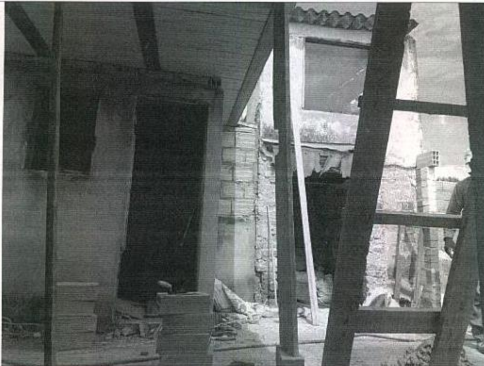
Fotografía 32 – En la parte frontal del predio, se evidencia la construcción de un nivel adicional a la altura original del inmueble, con muros en mampostería y placa fácil en el entre piso. (Fecha de toma de la imagen 18/07/2022).
