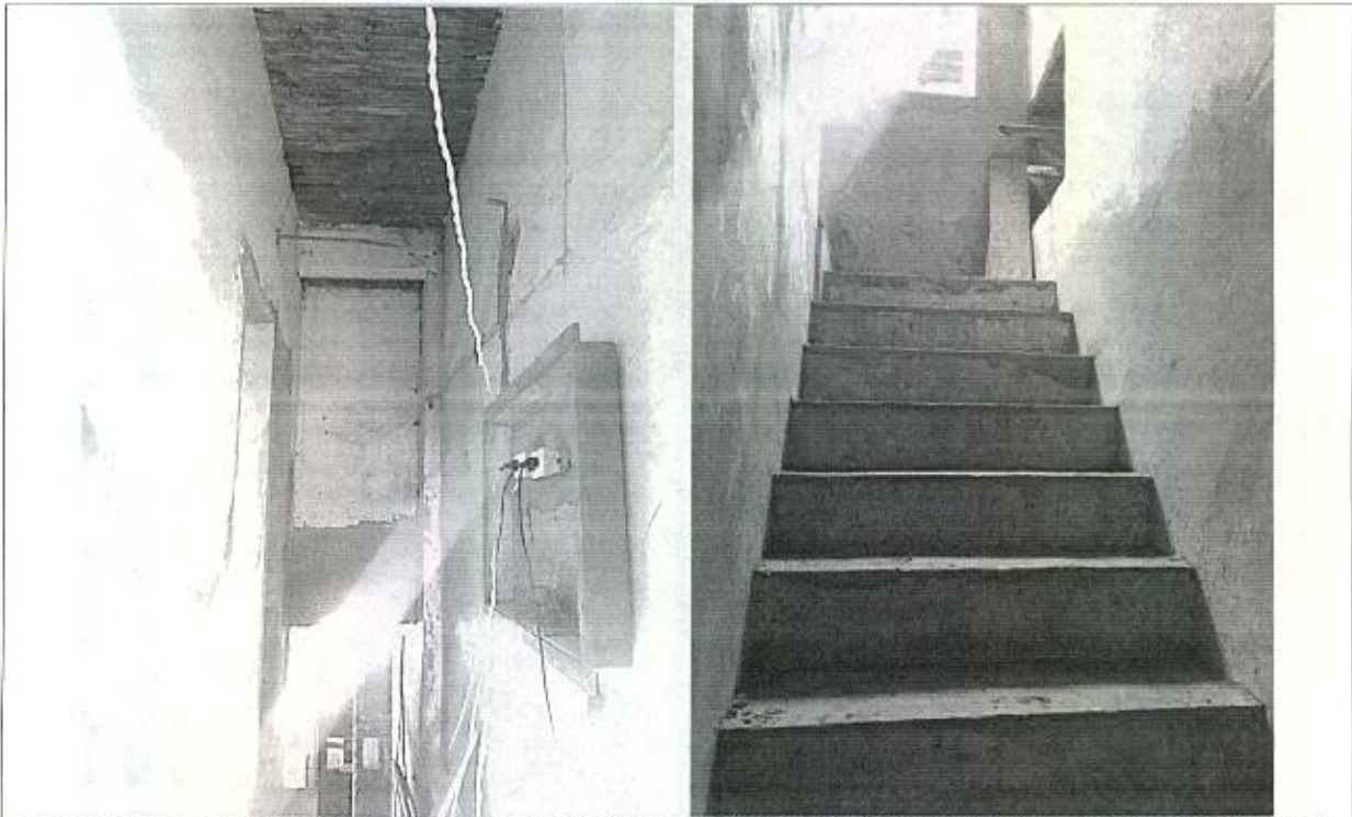
Fotografía 10 y 11 – Para acceder al segundo nivel del cuerpo frontal del inmueble, se debe acceder por otra escalera ubicada en la parte central del predio, recientemente construida. En los pasillos se evidencia la apertura de vanos para acceder a más espacios y escaleras y se observa el retiro de cielorrasos.
