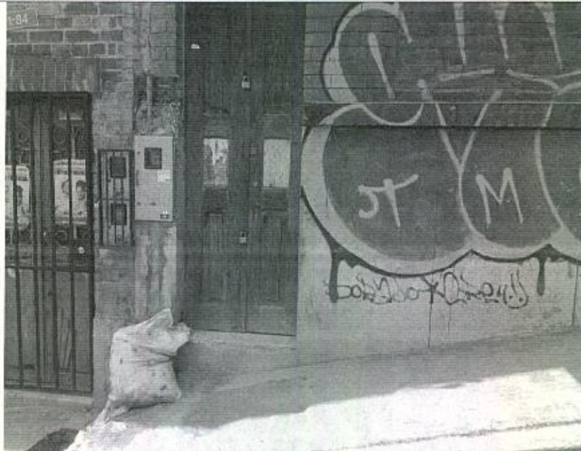
Fotografía 3 – En el costado izquierdo de la fachada se ubica el acceso principal al inmueble, en el marco del acceso se evidencia el cambio de redes y contador de energía eléctrica, así como escombros y desgaste en el andén. (Fecha de toma de la imagen 18/07/2022).
