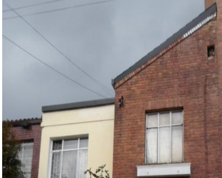
Foto 4- KR 16 A 48-56 remate de la fachada donde se observa un canal de aguas lluvias instalada recientemente, así como una lámina metálica cubriendo el remate de fachada de ladrillo a la vista, elementos que no se encontraban en el año 2020. (fecha de captura de la imagen: 11-02-2022)
