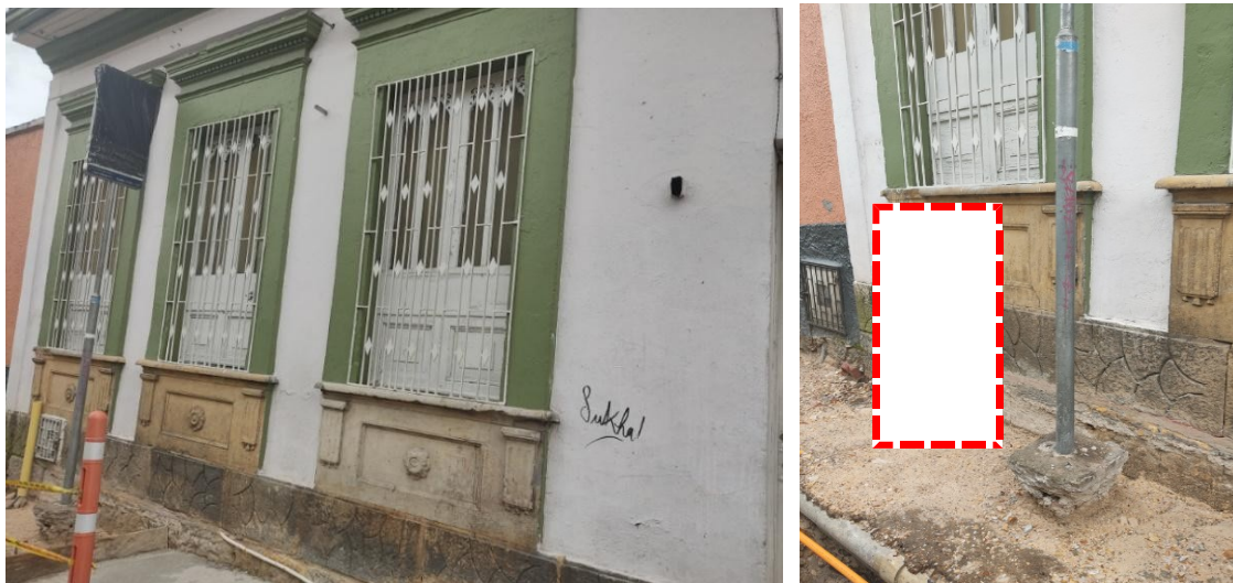
Fotografías 1 y 2, Fachadas principales del inmueble de la Carrera 4 No. 9-21, se observa instalación de punto provisional para el servicio de gas natural frente a la fachada.
