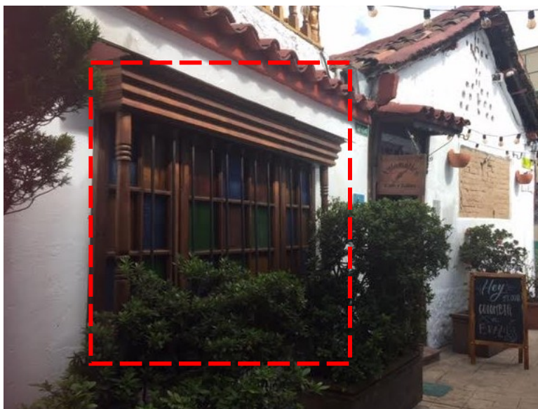
Fotografía 2: Se la construcción de una ventana sobre la fachada occidental que no aprobada en la Resolución No. 167 del 15/03/2019 expedida por el IDPC. (Fecha de toma de la fotografía: 3 de junio de 2021)
