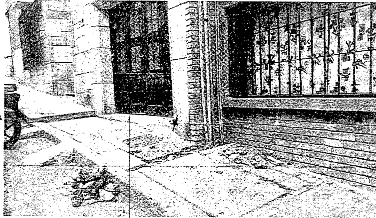
Caja de inspección instalada en el andén del inmueble localizado en la Calle 12D Bis No. 1A - 39/41. Fotografía 3 - (Fecha de toma de la imagen 5 de febrero del 2019).
