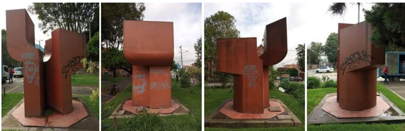
Imagen 32. Deterioros de tipo antrópico en los bienes muebles en espacio público.
